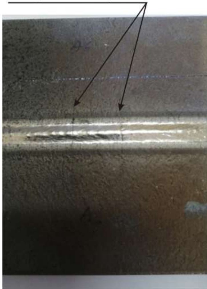
Поперечні холодні тріщини
