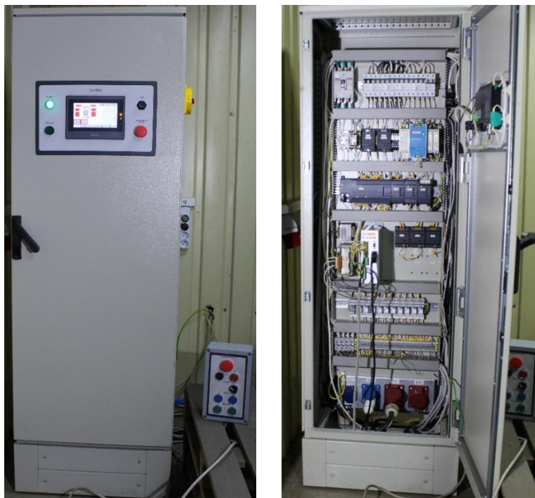
Рисунок 2.3 – Шафа керування комплексом обладнання для плазмо-дугового зварювання різнополярним струмом.
