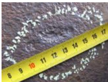
Рис. 1. Приклад корозійного пошкодження на поверхні магістрального газопроводу «Новопсков - Аксай - Моздок», Луганське ЛВУМГ
